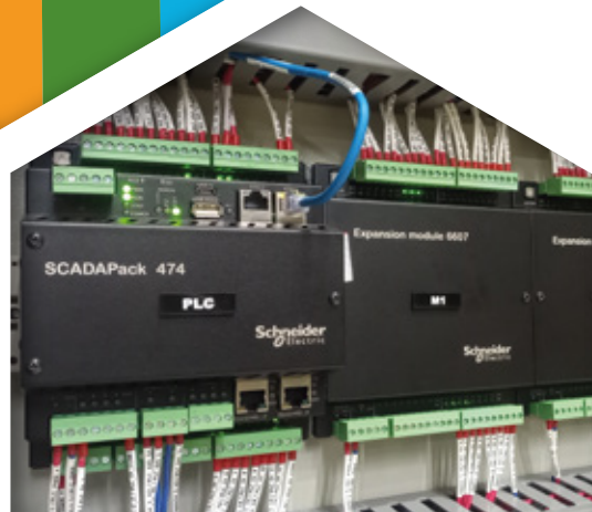
INSTRUMENTACIÓN Y CONTROL SISTEMAS SCADA
